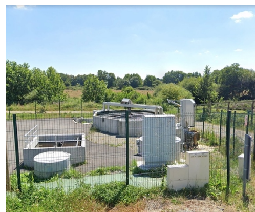
Station d'épuration de la Ville Oger
