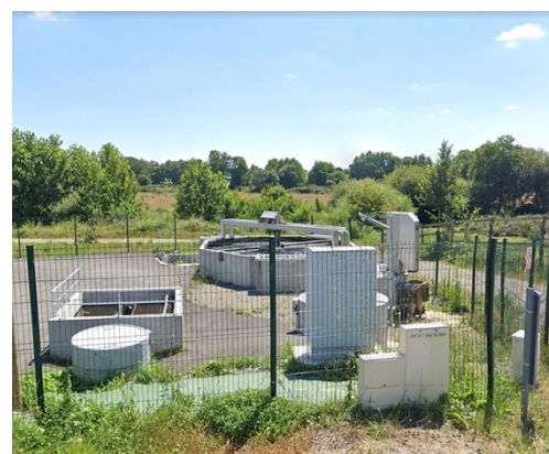
Station d'épuration de la Ville Oger
